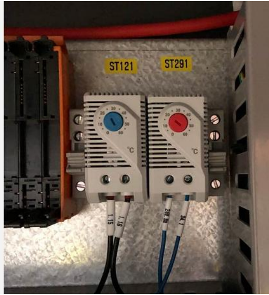
图 4-3 检查通风操作
