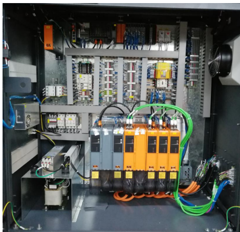
图 4-10 检查主要电气元件工作情况
